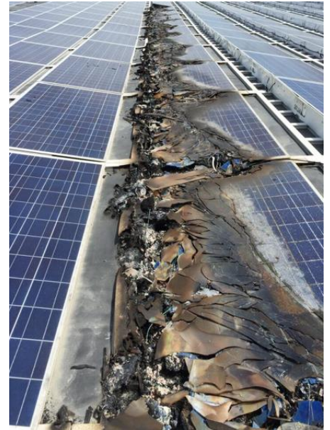
Väärin asennettu paneeli on paloturvallisuusriski.
